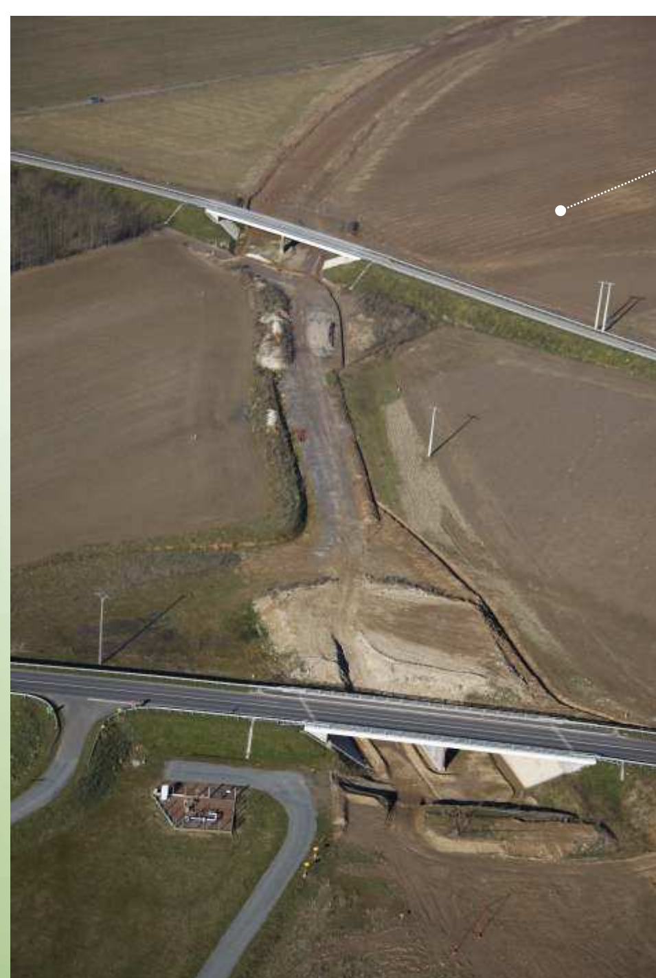
vue sur les OA2 et OA3 rétablissant la Route Départementale 49 et le chemin aux ânes
