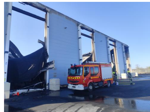
ARIA 63814 – Incendie centre de regroupement et transfert déchets collecte sélective (source photo: SDIS 54)
