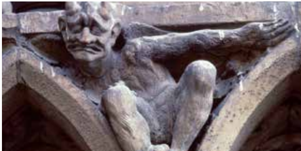
Le patrimoine bâti peut être dégradé par la pollution atmosphérique.
