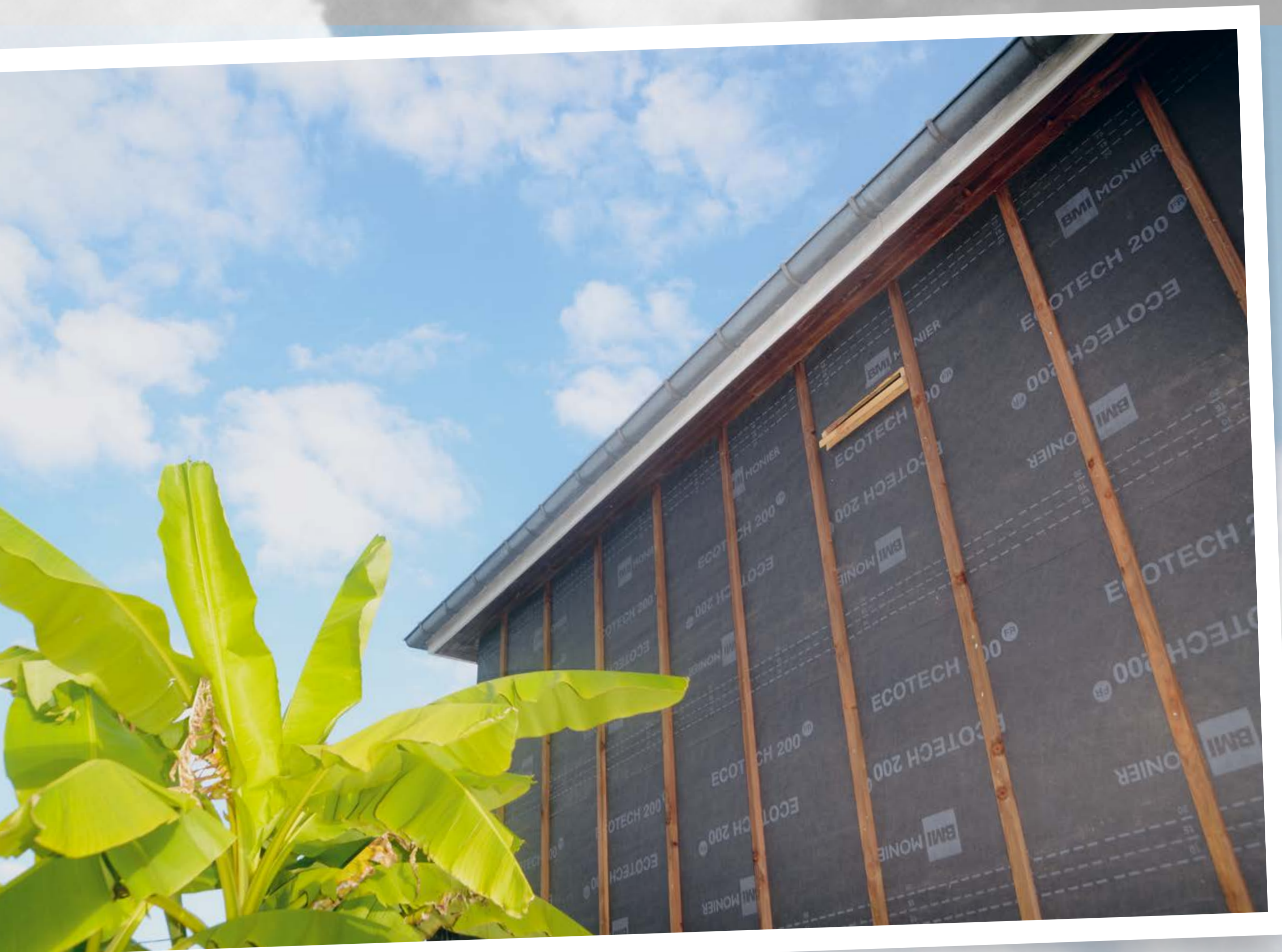
Le Plan Climat doit prendre en compte les chauves-souris dans tous les types de rénovations thermiques. Ici un gîte bientôt inclus sous le bardage d'une maison particulière.
