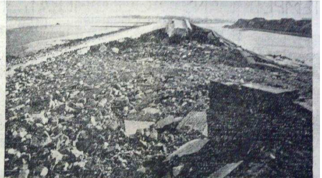
Une vue particulièrement saisissante de la plus importante des deux brèches créées dans la digue Tixier. — A droite, le canal existant et le bastion 22. (Photo Desormaux - M&G)
