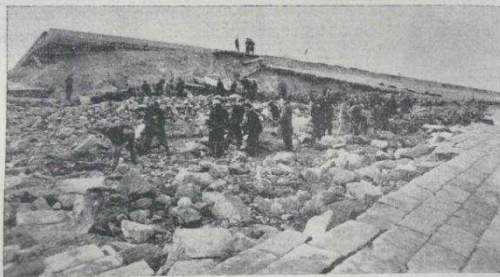
Au cours de la journée de Mercredi et de la nuit suivante, la situation n'a pas sensiblement évolué à la digue Tixier et le long du canal existant. La merée de Jeudi matin, à 4 heures, n'a semble pas avoir causé de graves dégâts. Quelques pans de béton ont encore été enlevés au bastion 22 de l'implantation d'un des bords caux, dirigés à la base, d'un règlement accidentel, et en quelques endroits des berges voisines. L'arrangement des levés de gabions et de sacs de sable aux extrémités des tronçons de la digue se poursuit. Le travail organisé en équipes s'effectue d'une merée à l'autre. (Photo Desormaux - M&G)
