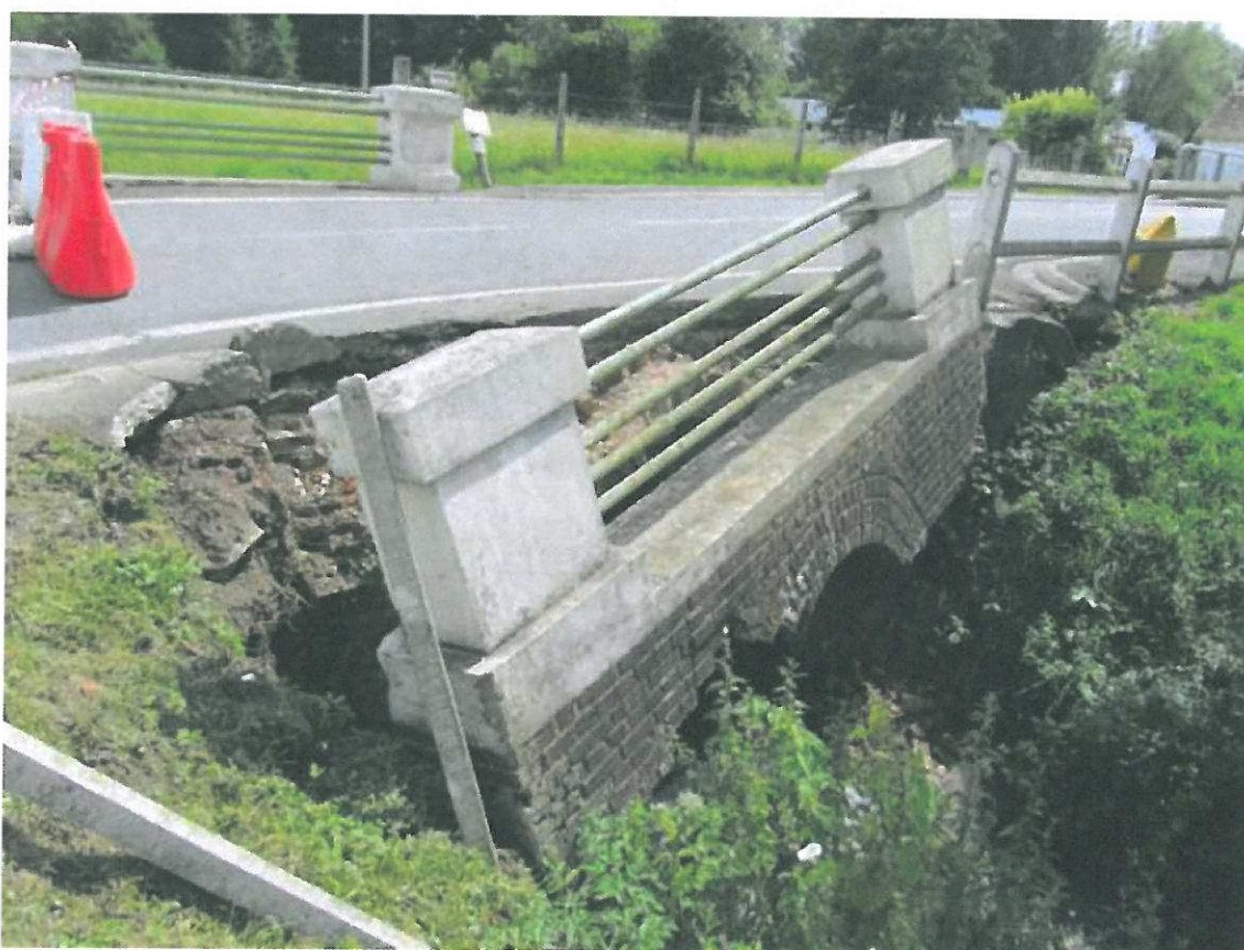
Vue aval de l'ouvrage existant après choc du 30 juillet 2012
