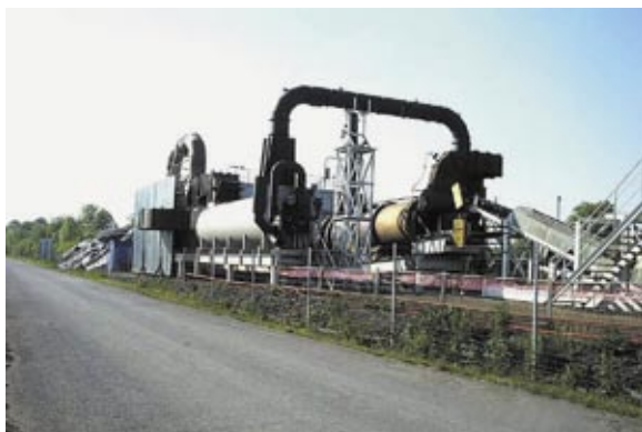
Installation de traitement de sols pollués par désorption thermique sur le site de la cokerie d'Auby
