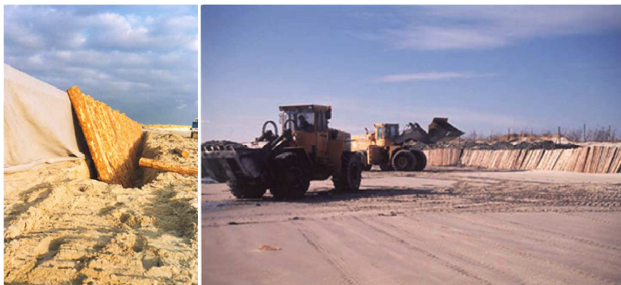
Figure 28 : Pose de rondins de pins en renforcement de la digue de sable.
