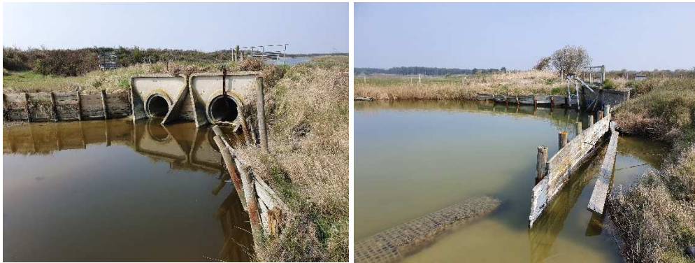
Figure 59 : Clapet et batardeau à la vanne mer
