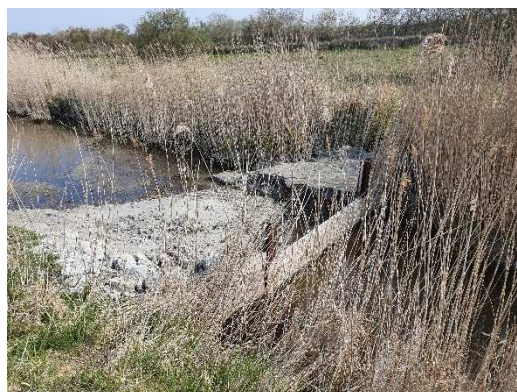
Figure 60 : Batardeau d'écoulement des eaux douces
