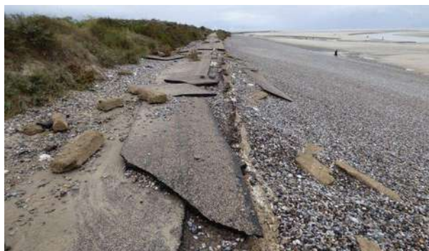
Figure 81 : Erosion et attaque de la route blanche en septembre 2019 (source : SMBS-GLP)
