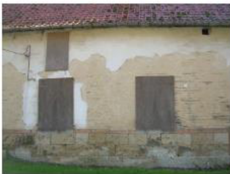
Bâtiment abandonné en torchis enduit à Chaussoy Epagny
