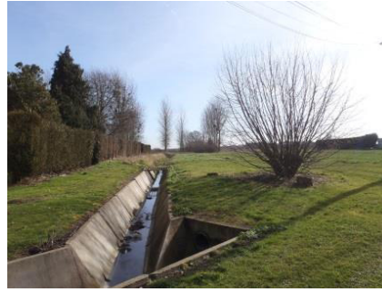
Bassin de lagunage à Sourdon
