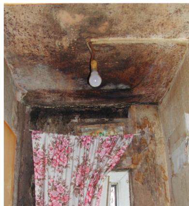
Moisissures dans un logement
