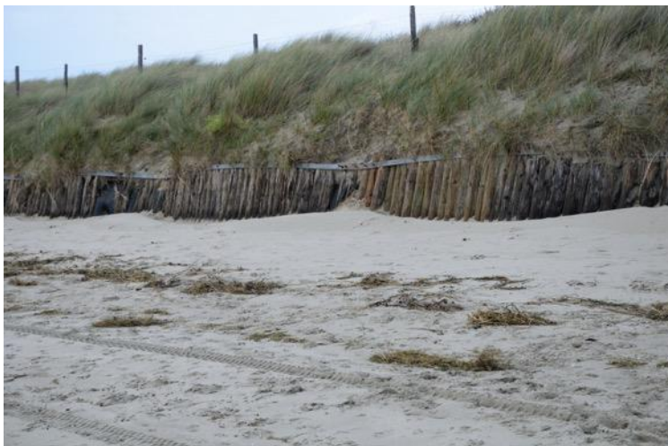
Figure 4 : partie dégradée de l'ouvrage en rondins servant de protection à la digue du Parc ornithologique
