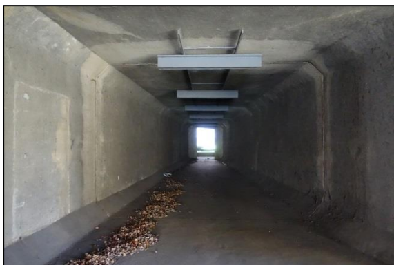
Figure 5 : Galerie de ventilation
