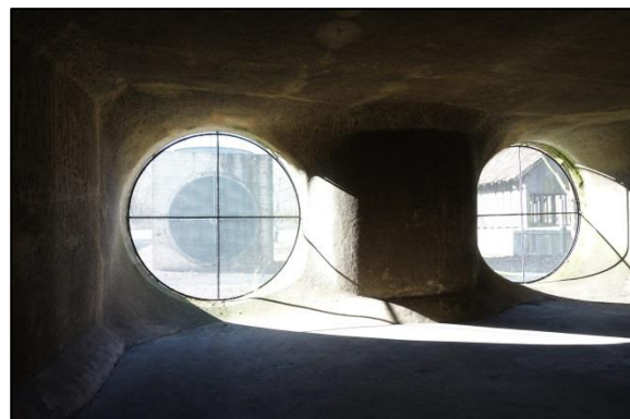
Figure 6 : Galerie de ventilation
