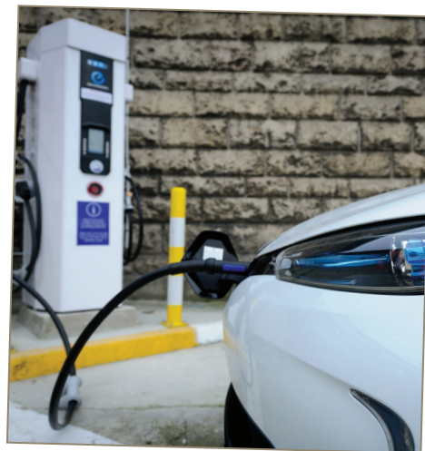
Chargement d'un véhicule électrique
