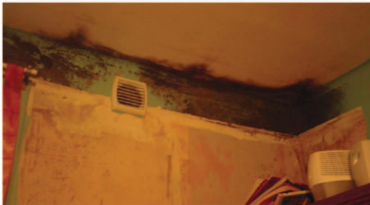
Condensation et développement de moisissures lors d'une rénovation en site occupé
