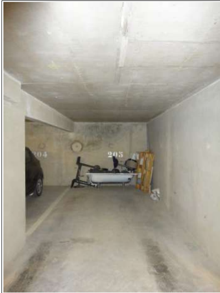
stockage d'objets divers dans un parc de stationnement réservé uniquement au stationnement des véhicules
