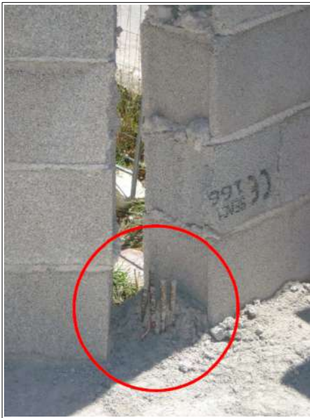
chaînage vertical : attentes trop courtes
