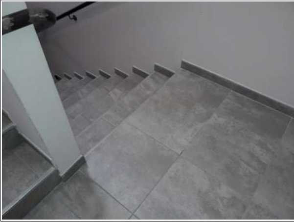
absence d'élément d'éveil à la vigilance dans un escalier
