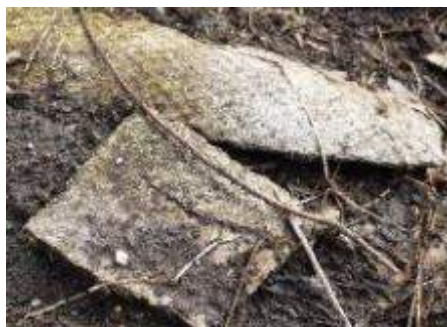
Figure 5 : Matériaux susceptibles de contenir de l'amiante (à proximité de BGP3)
