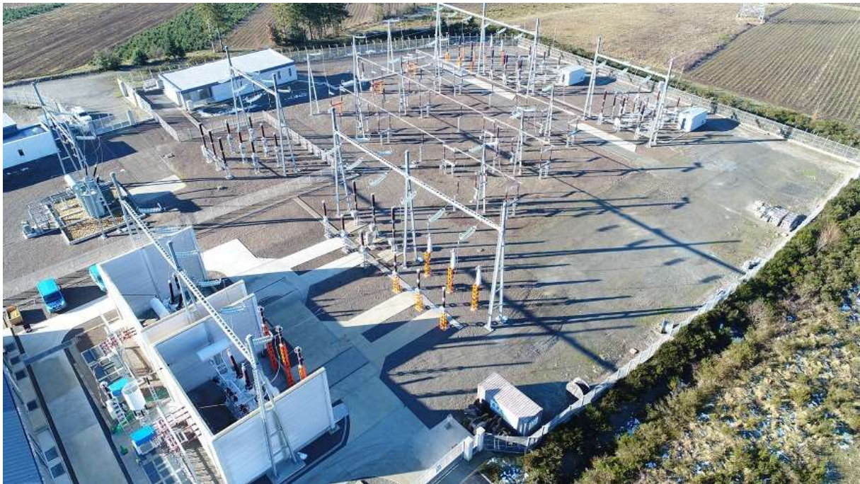
Vue d'un poste source électrique
